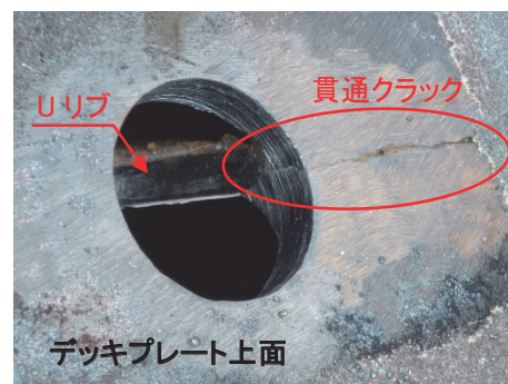
図 3 デッキプレート貫通クラック（他橋の事例）
