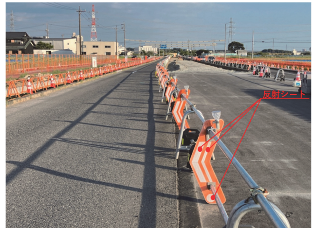
写真-3 反射板付き矢印(単管バリケード用)
