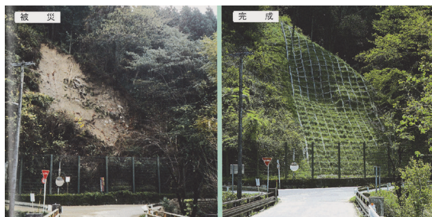
写真-1 平成元年被災と対策状況（西側） （出典：恵那・東加茂災害の記録，豊田建設業協同組合）
