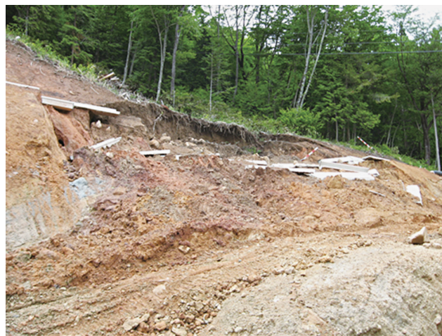
写真3 切土法面の崩落
